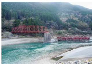
現地視察で見た肥薩線の鉄橋崩壊
